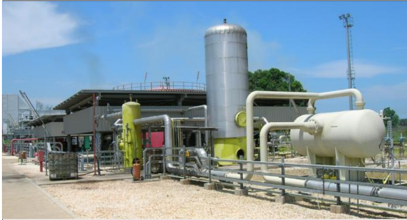
La centrale à gaz de Djéno à Pointe-Noire
