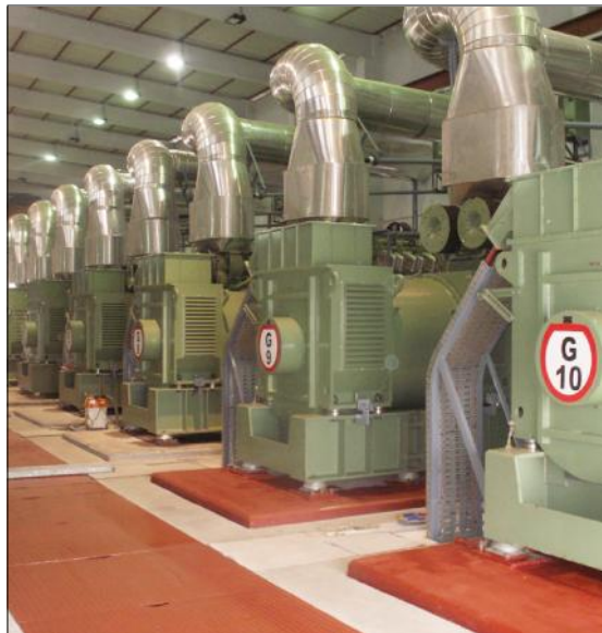
Les groupes de la centrale thermique de Brazzaville
